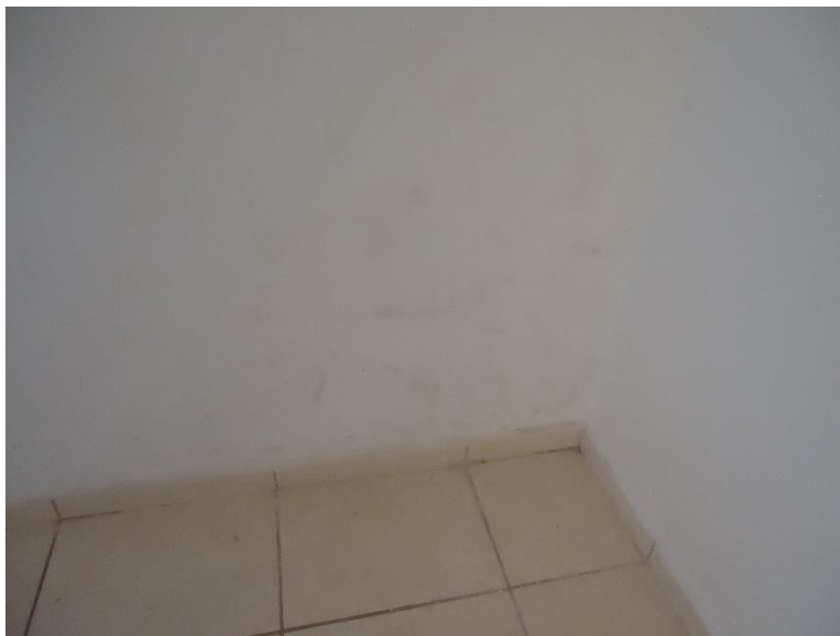
Quarto lado direito: piso cerâmico, parede com sinal de umidade.
