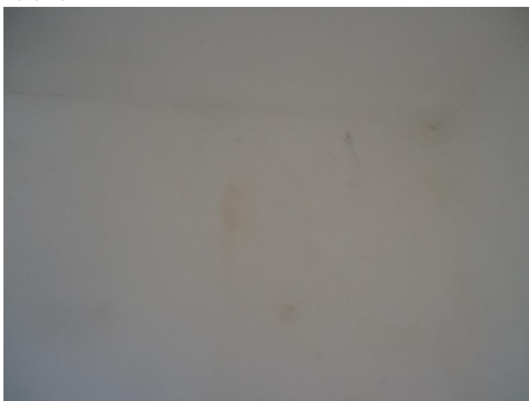
Quarto lado direito: paredes e forro com sinais de umidade.
