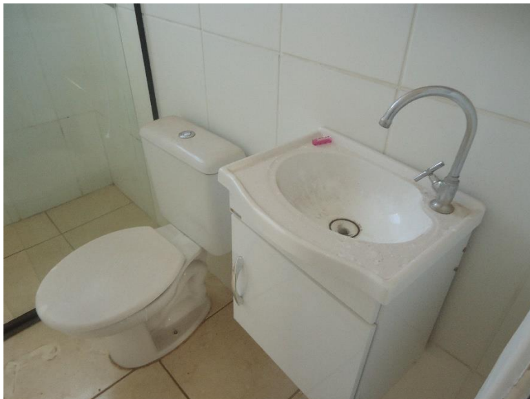
Banheiro: vaso sanitário com caixa acoplada, pia.
