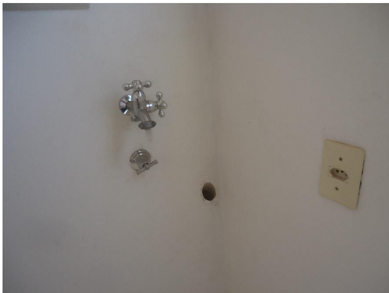
Torneira na área de serviço.
