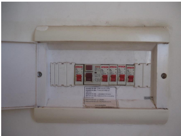
Quadro de distribuição de energia elétrica.
